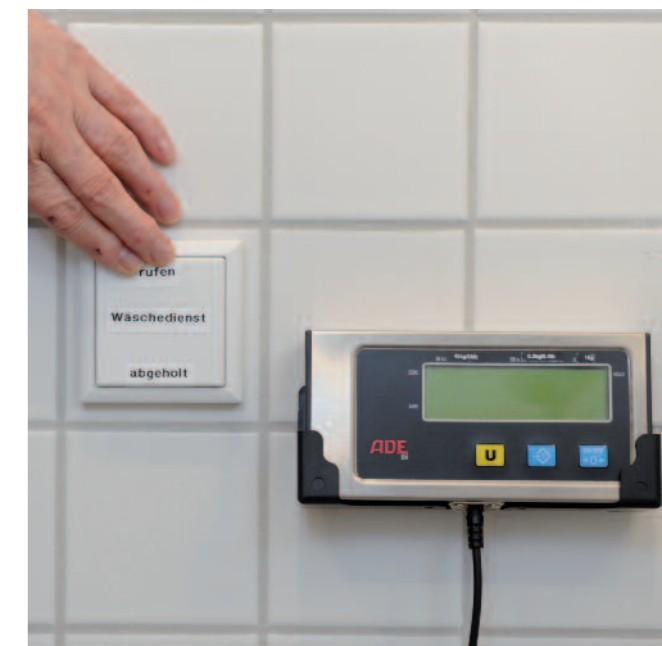
...der manuell oder über eine automatische Füllstandsanzeige des Wäschekorbs aktiviert werden kann
